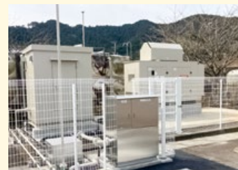
ゴールドヴィレッジほらど非常用自家発電設備
