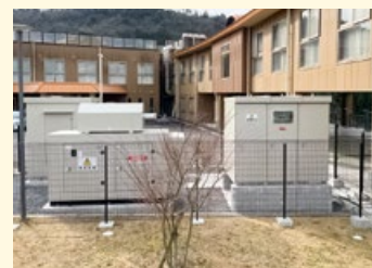
アルトシュタットとみか非常用自家発電設備
